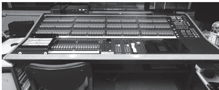
田園ホール照明舞台設備（照明操作卓） この操作卓内にある基盤（CPU）を入れ替える
