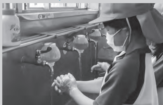
レバー化された学校の蛇口（不動小学校）
