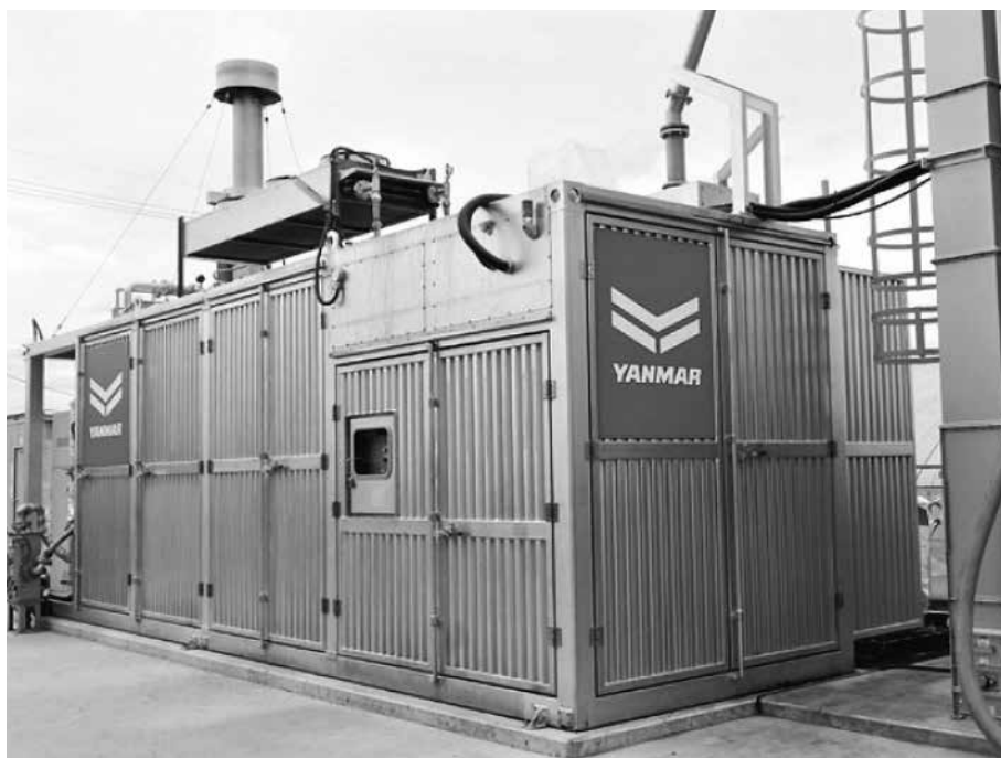
もみ殻ガス化発電システム(実証試験中) 写真提供: ヤンマーエネルギーシステム(株)
