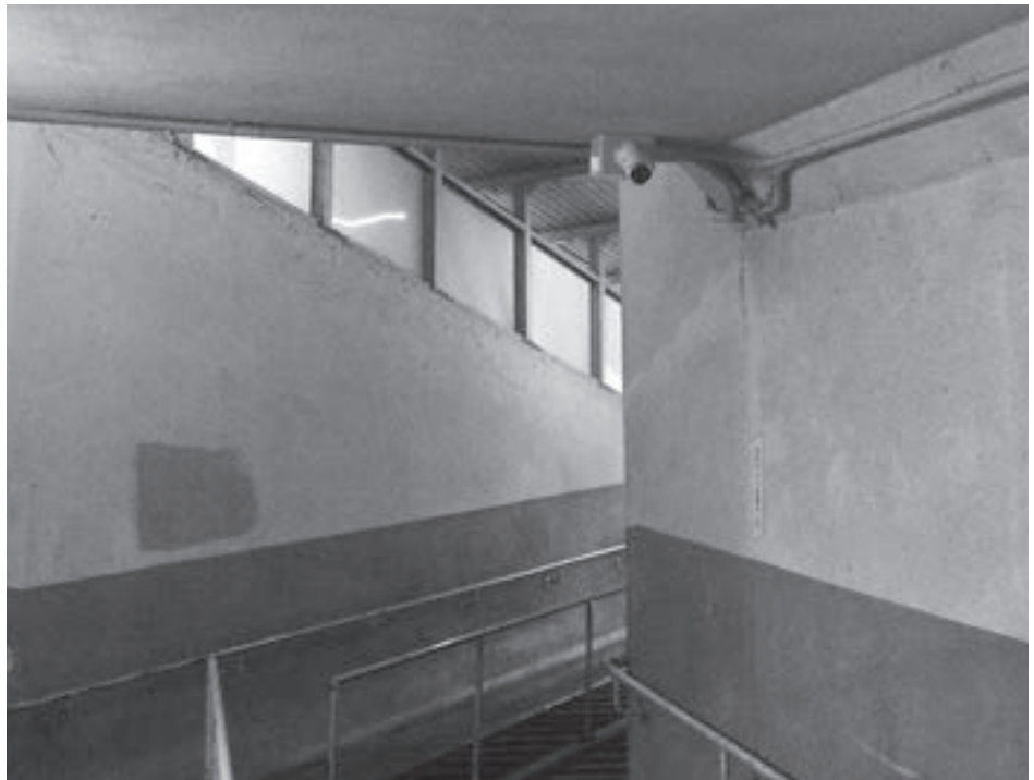
防犯カメラが設置されている南矢幅地下道
