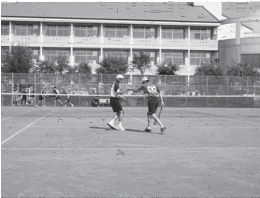
破損箇所がある矢巾北中テニスコートの人工芝 (早期の修理が望まれる学校設備)
