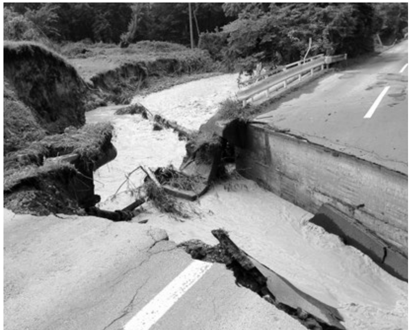
平成25年8月9日の大雨災害で崩落した山王茶屋前橋
