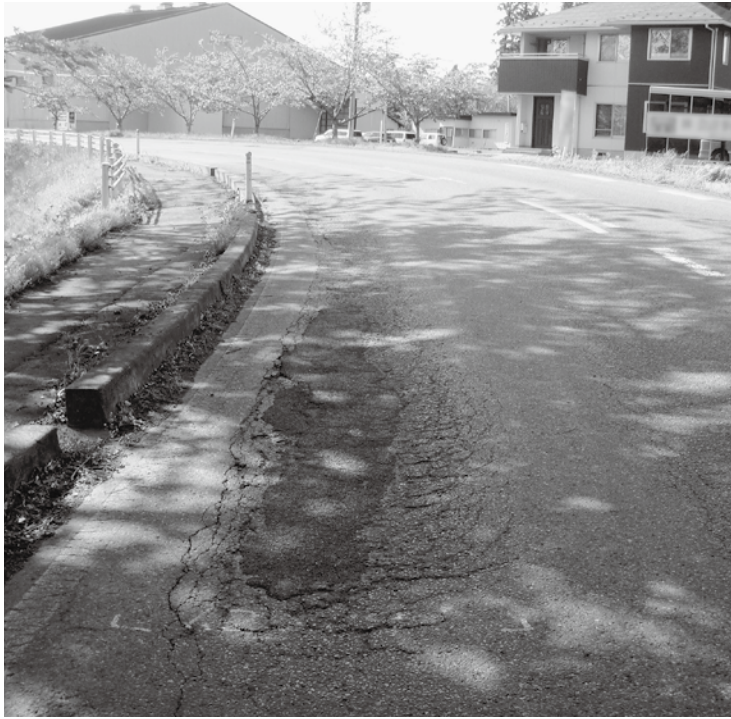
補修予定の浅草谷地1号線(赤林地内)
