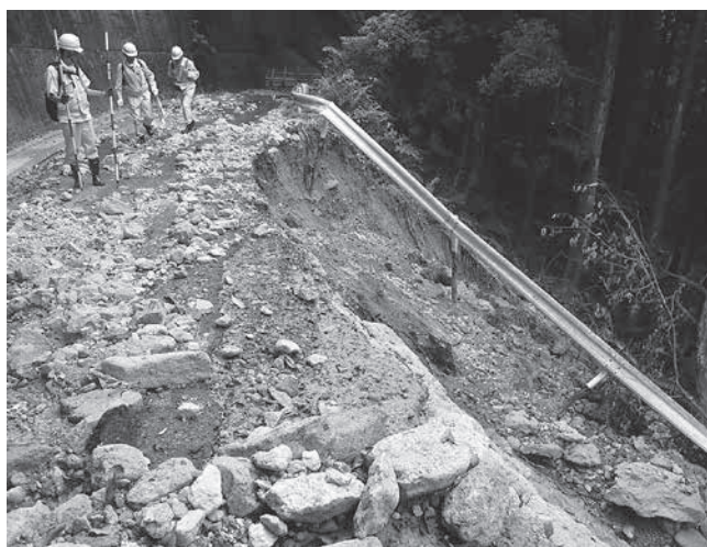
災害復旧工事が予定されている南昌山線
