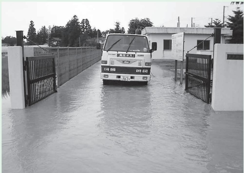
大雨災害で被災した矢次下水処理場
