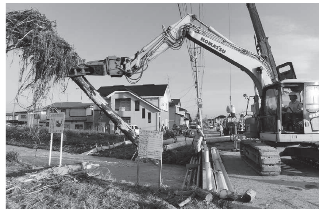
流木除去中の下海老沼橋（新田1区）
