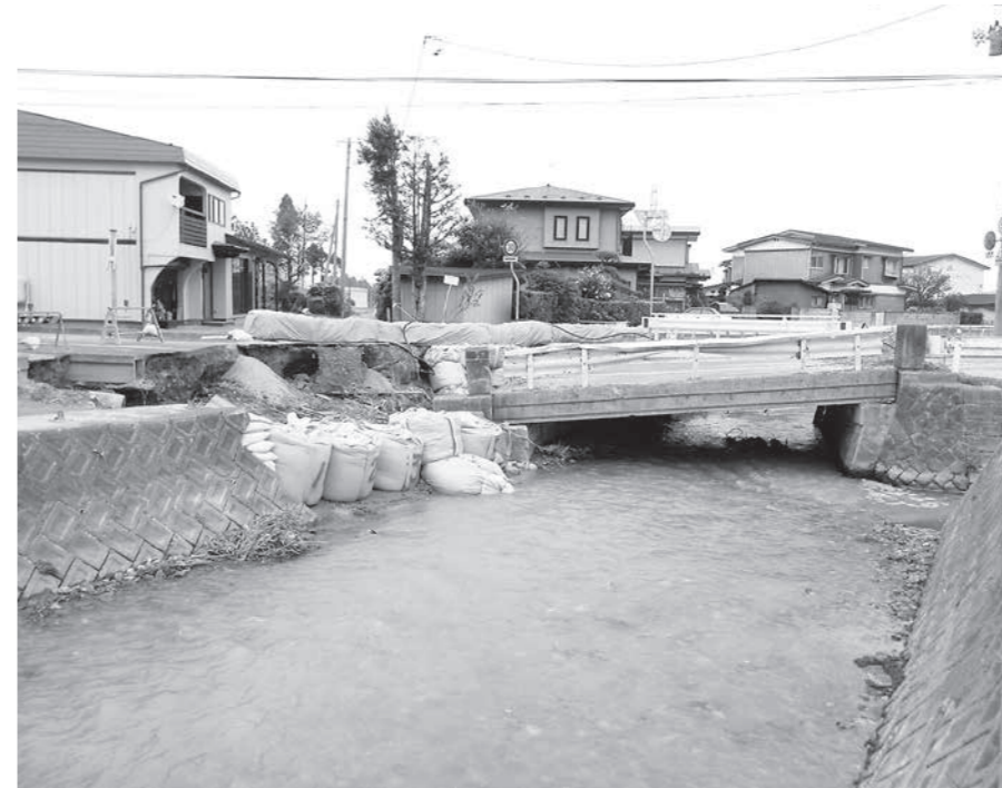
崩落した岩崎川橋（矢次地区）
