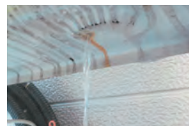
設置から10年以上経過したホームタンクで、内部に水が溜まって穴が空き灯油が流出した事例
