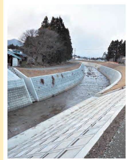
特別緊急事業で改修が行われた岩崎川の一部（六助橋上から北西方面を撮影）
