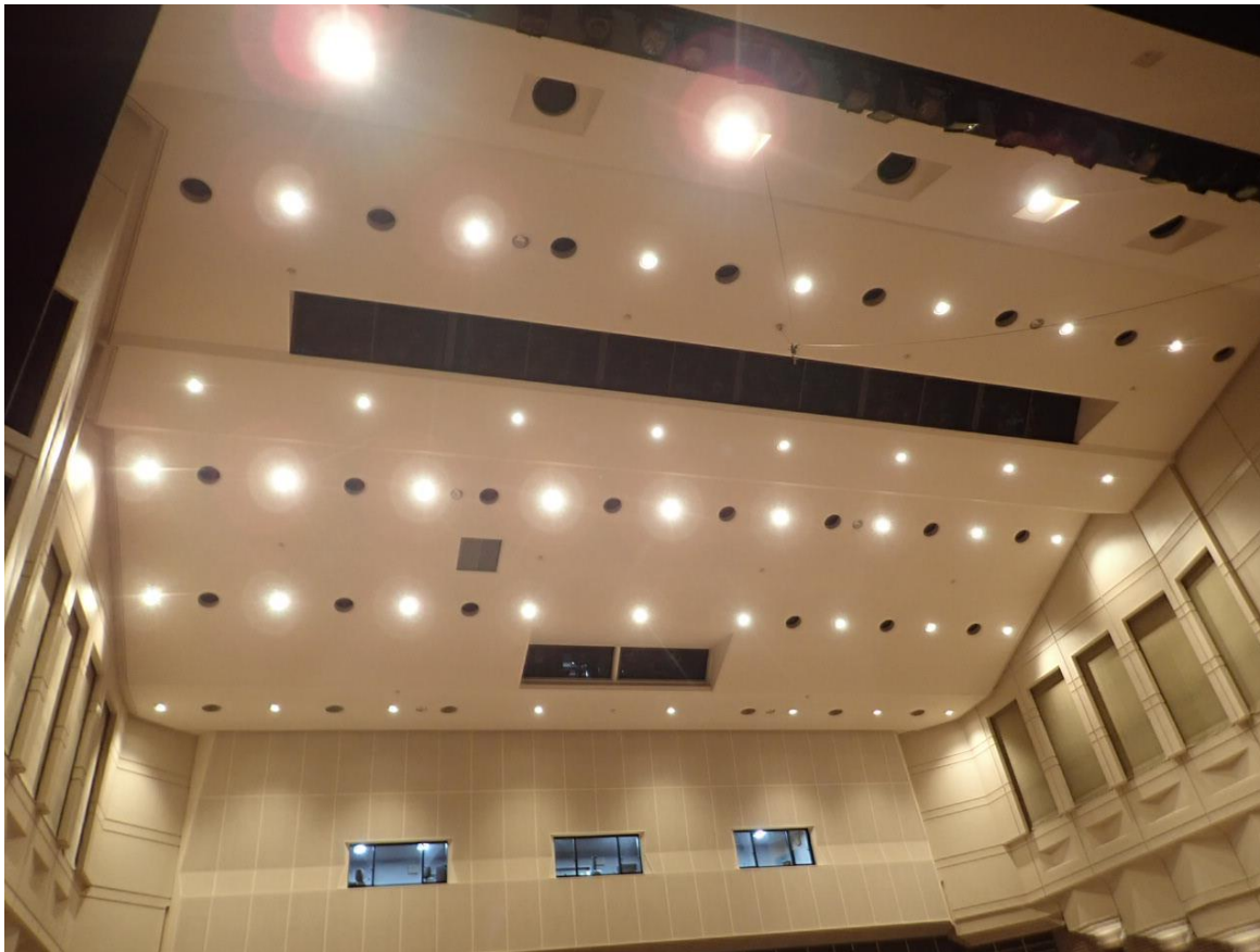
←田園ホール照明LED化
