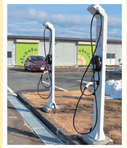
役場敷地内に設置したEV充電ステーション
